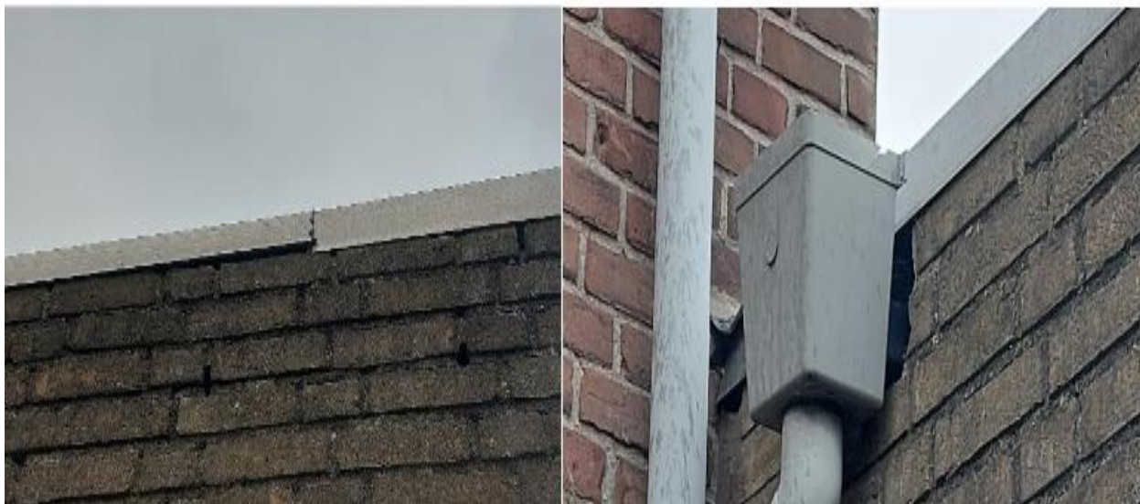
Bij de ingang sluit de daktrim niet nauw aan op de gevel en is er bij de goot een opening in de gevel aanwezig waardoor vleermuizen hier in kunnen verblijven en mogelijk de spouw kunnen bereiken. Bron: Aeres Milieu
