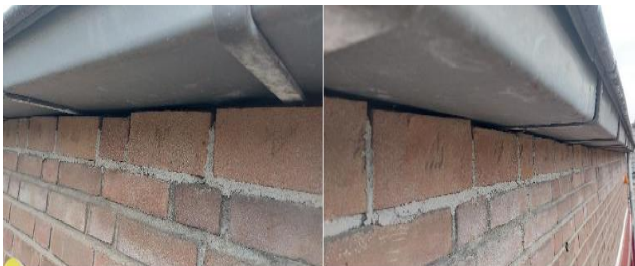
Tussen de goot en de gevel zijn veel spleten aanwezig waar vleermuizen in kunnen verblijven en mogelijk de spouw kunnen bereiken. Bron: Aeres Milieu
